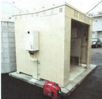
災害時に炊き出しができる充電式発電機と履帯付き倉庫も備えた
